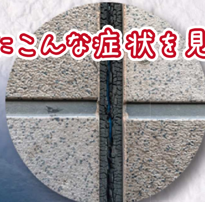
✓ シーリング劣化
